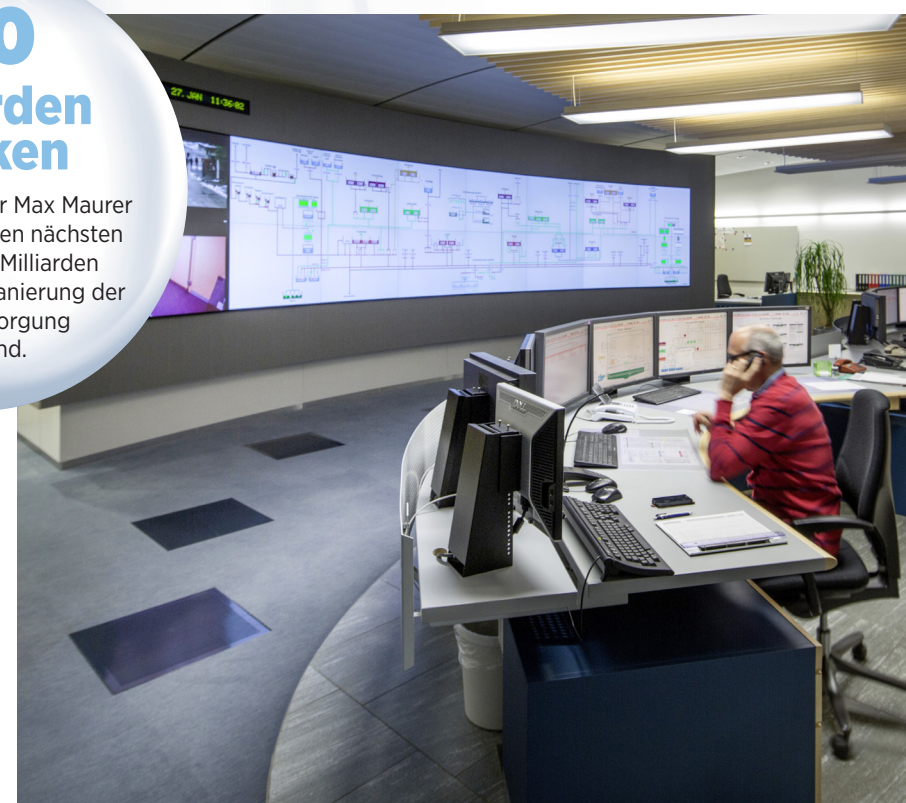
Bombensichere Wasserversorgung: Der Kontrollraum im Bunker des Zürcher Grundwasserwerks Hardhof.
